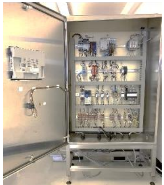
*(MIT36-150 PLC 제어부 실제 이미지)
